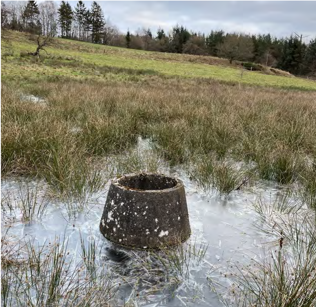
Figur 37 Brønd ved afvandingsystem 19
