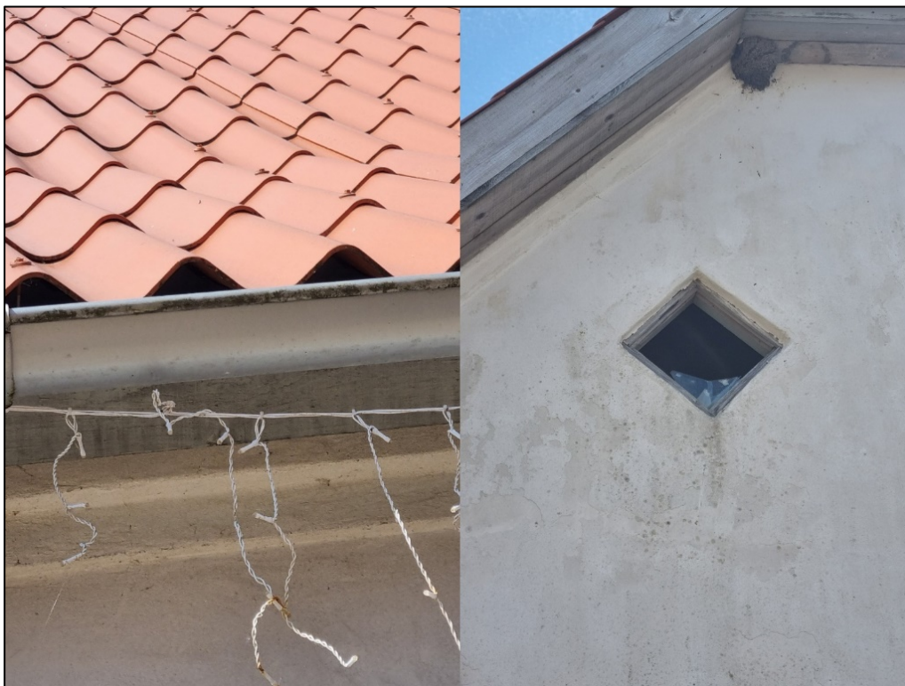
Udvalgte billeder over potentielle flagermus levesteder. Tv.: Mulige indgangshuller under tagkonstruktion på Firhusevej 7. Th.: Muligt indgangshul i gavlen af bygning på Firhusevej 7.
