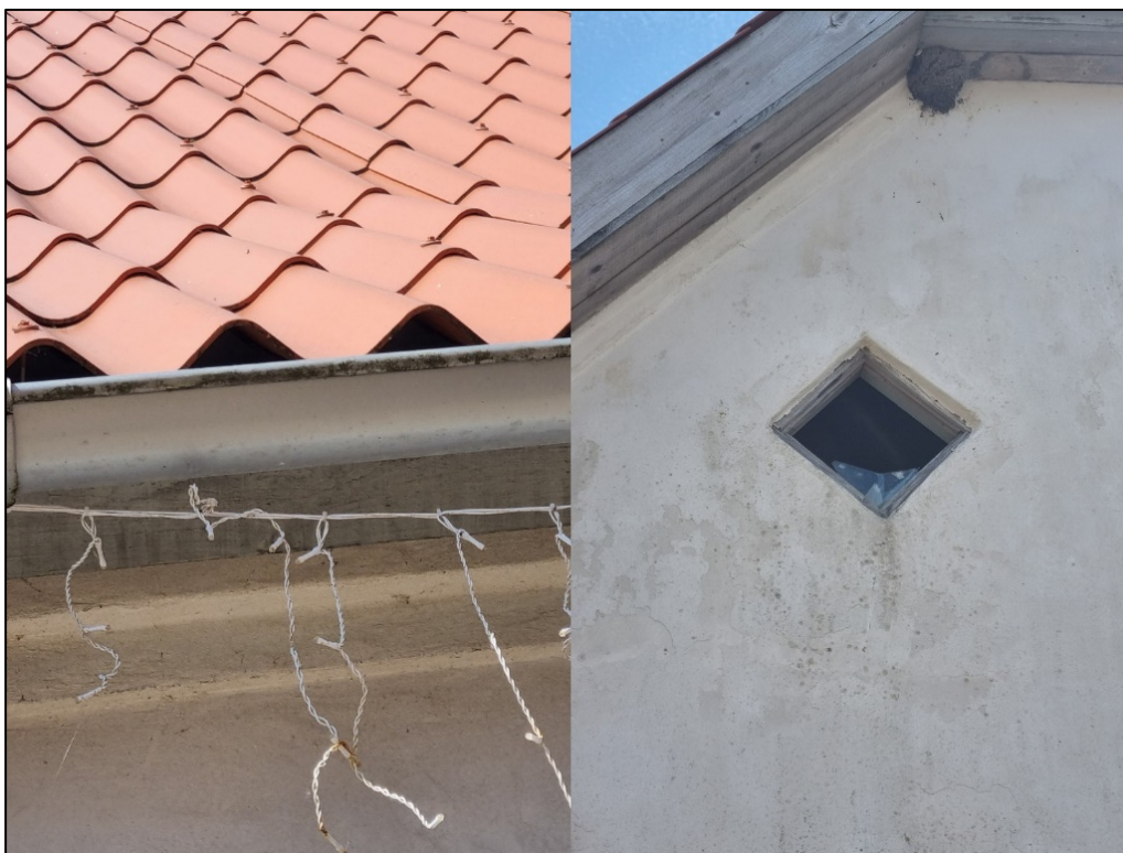
Udvalgte billeder over potentielle flagermus levesteder. Tv.: Mulige indgangshuller under tagkonstruktion på Firhusevej 7. Th.: Muligt indgangshul i gavlen af bygning på Firhusevej 7.
